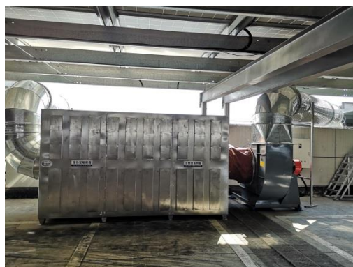
印刷废气处理设备
