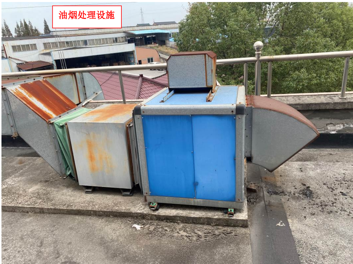
实验室废气处理设施
