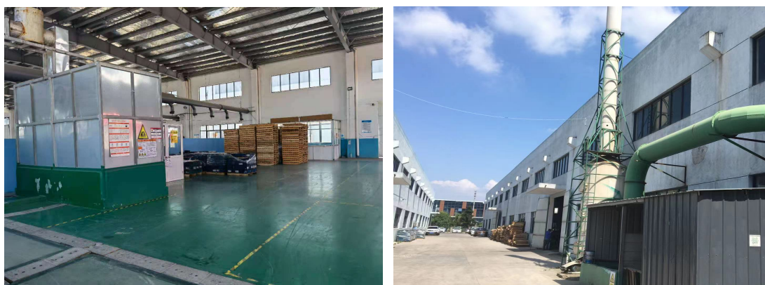
图 4.1.4.2-1 密闭隔间及酸雾废气处理设施
