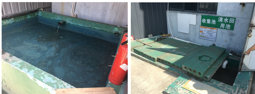
图 4.1.4.1-1 打磨废水收集过滤池（地上式）、清水池（地下式）
