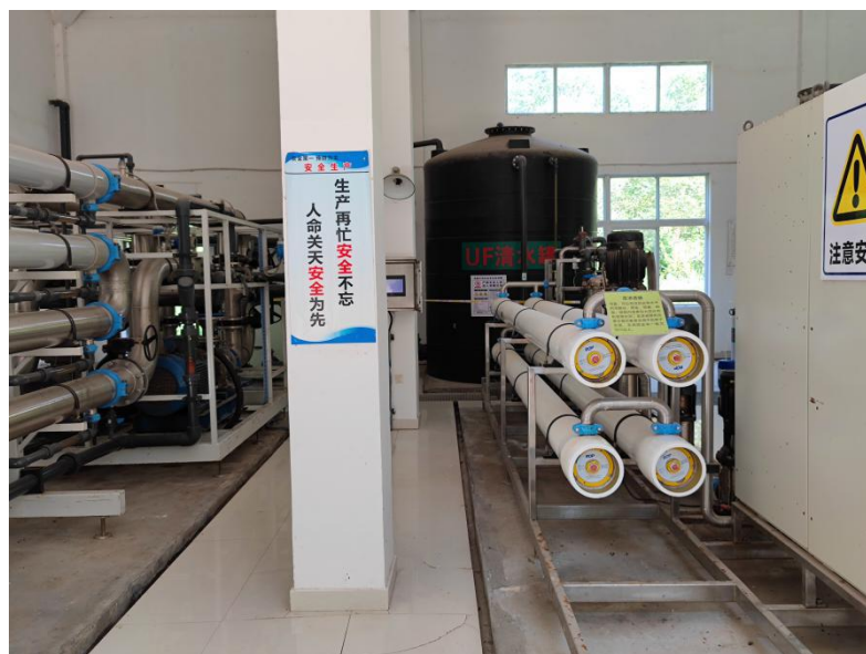
渗滤液处理站膜处理间 (污水处理设备离地 10 公分, 下方设置水泥基础, 处理 间内地面铺设瓷砖, 未发 现设备出现渗漏)
