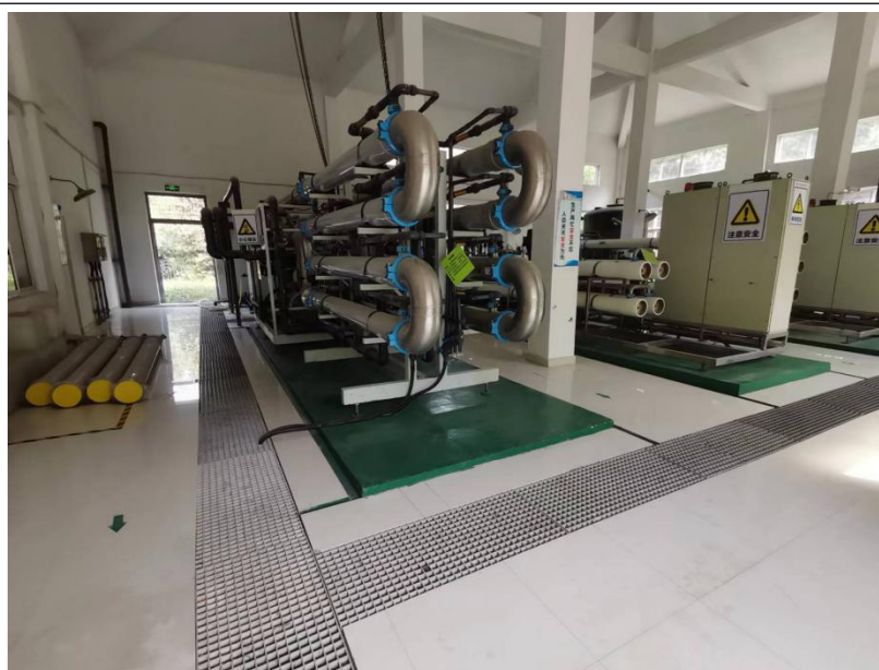
渗滤液处理站膜处理间
