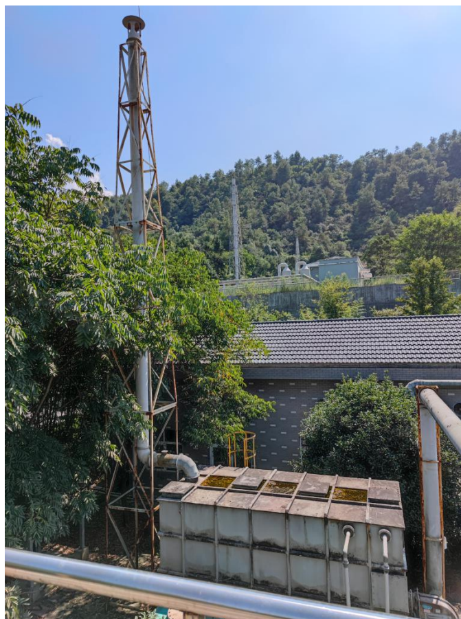
图 4.1.5-1 渗滤液处理区臭气收集及处理
