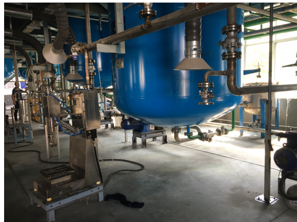
3#生产车间及废气收集系统
