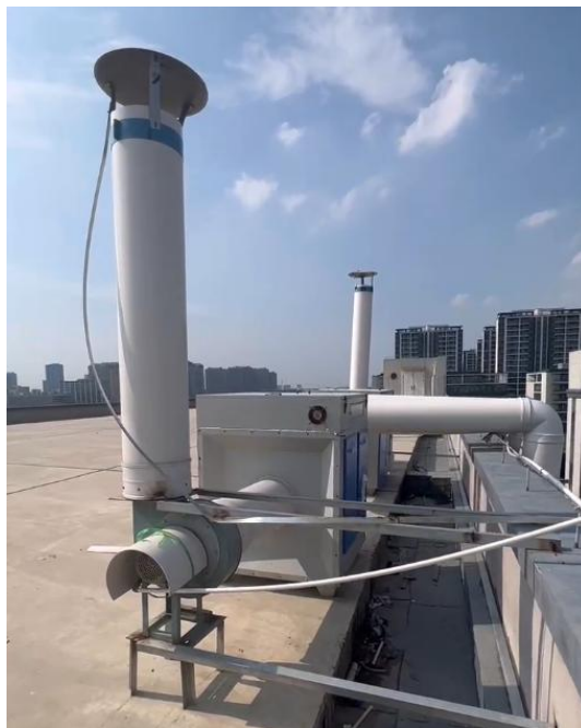
废气处理设备照片
