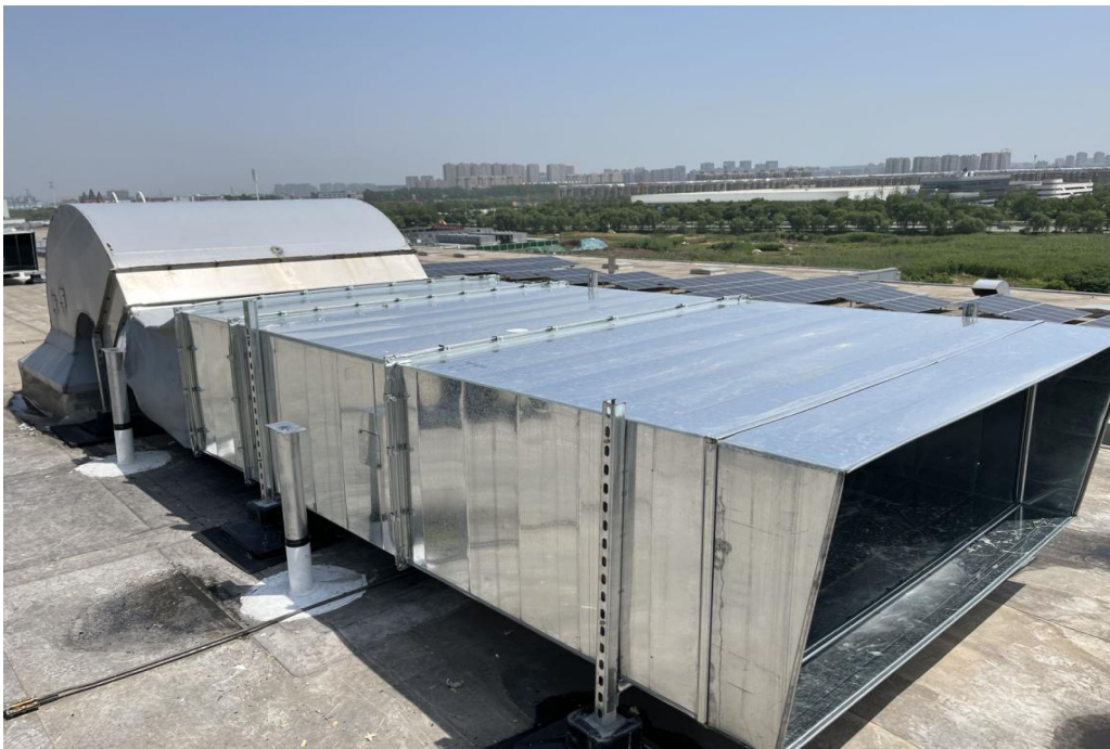
图 2-3 注塑废气处理设施排放口
