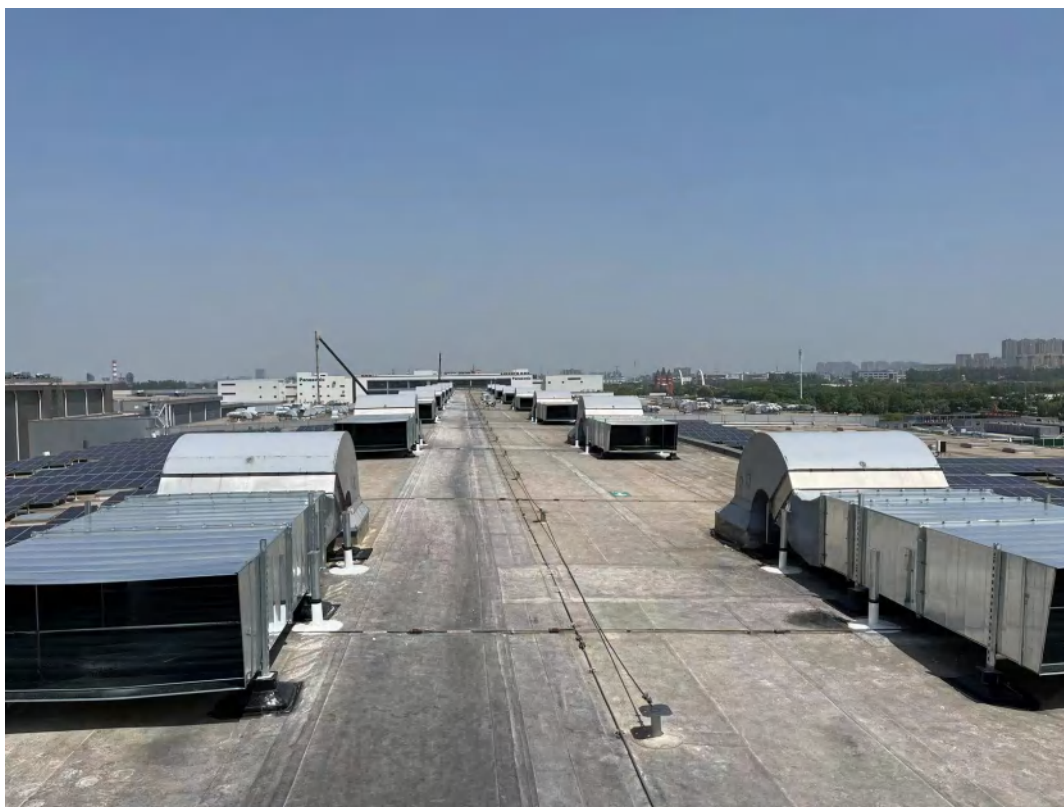
图 2-3 注塑废气处理设施排放口
