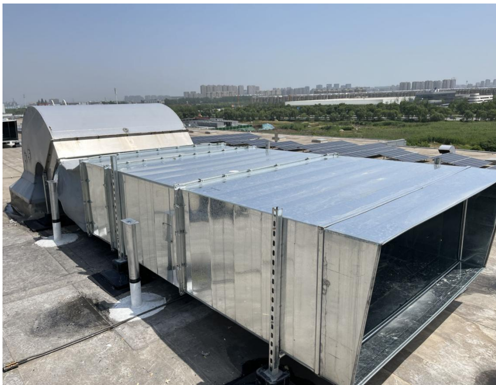
图 2-3 注塑废气处理设施排放口
