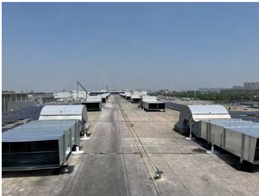
图 2-3 注塑废气处理设施排放口
