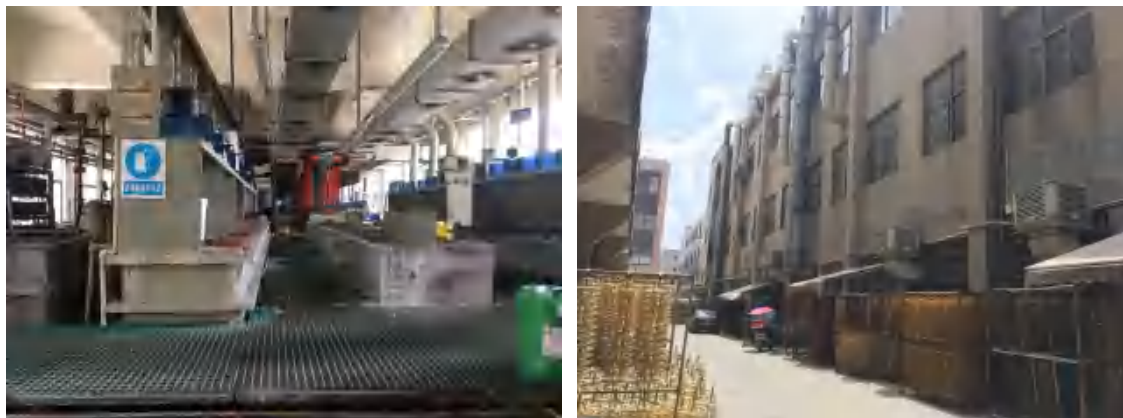
图 4.1-6 车间废气收集及处理
