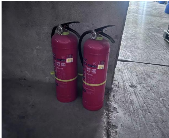
厂区内消防灭火器
